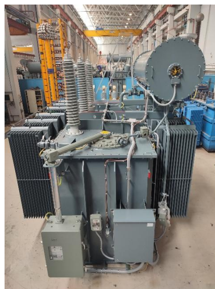
TR 25 MVA ONAN 132/15.6KV
